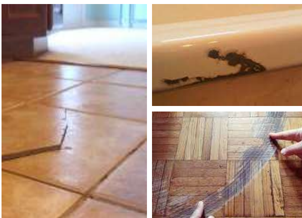
Defectos o daños previos al siniestro
